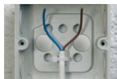
Kábel húzásmentesítés kábel kötegelővel, a doboz aljához való csatlakoztatáshoz
