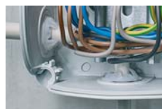
Kábel kicsúszás elleni védelme kábelrögzítőkkal
